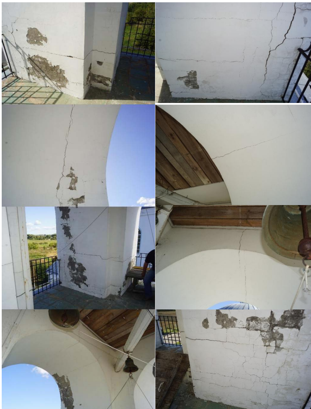
Рис. 4. Многочисленные дефекты по стенам колокольни (горизонтальные и вертикальные трещины различной природы, разрушение отделки)
