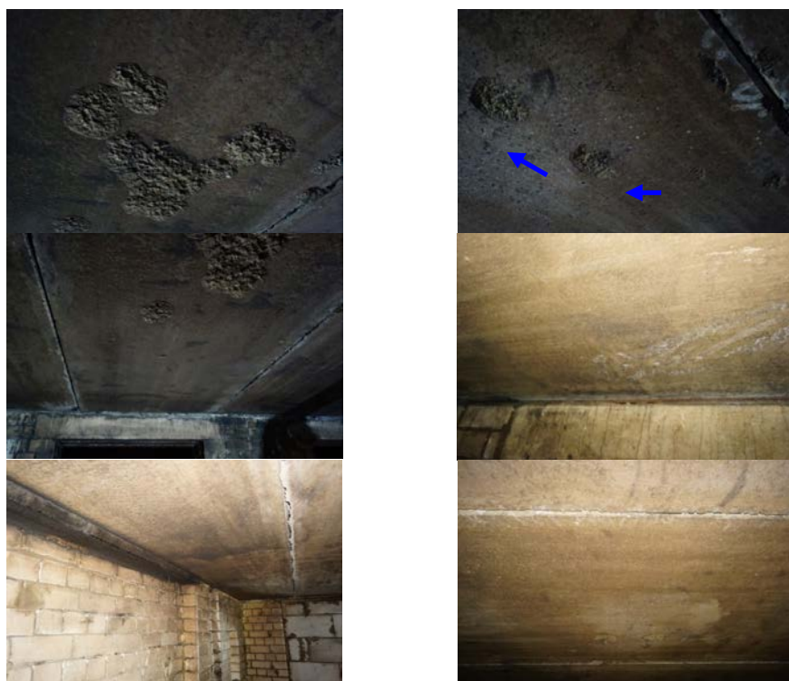
Рис. 1. Дефекты плит. Общие виды помещений
